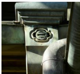
図17 中棟1階東側の雨樋集水器
